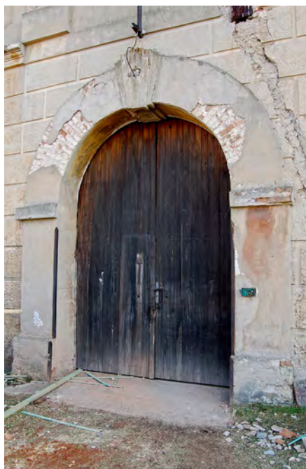
Skalka (okr. Litoměřice), hlavní vstup v severním průčelí zámecké budovy, obráceném do dvora. Kdysi k němu vedlo schodiště o třech stupních, nahrazené v roce 1958 betonovou rampou. Stav 21. března 2009, foto autor.
